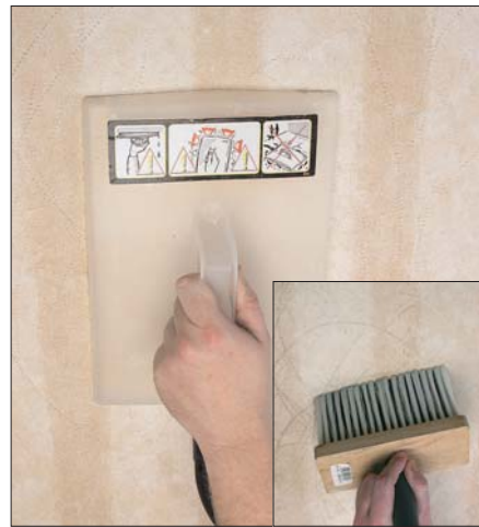
Dampen fra tapetafdamperen opløder klisteret bag tapetet. Eller brug tapetopløser fortyndet med vand 1:7 påført med en kalkkost.
